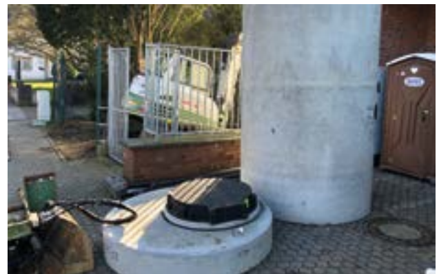
Bau eines Pumpenschachtes zur Verbesserung des Starkregenschutzes für die Grundschule im Februar 2020.
