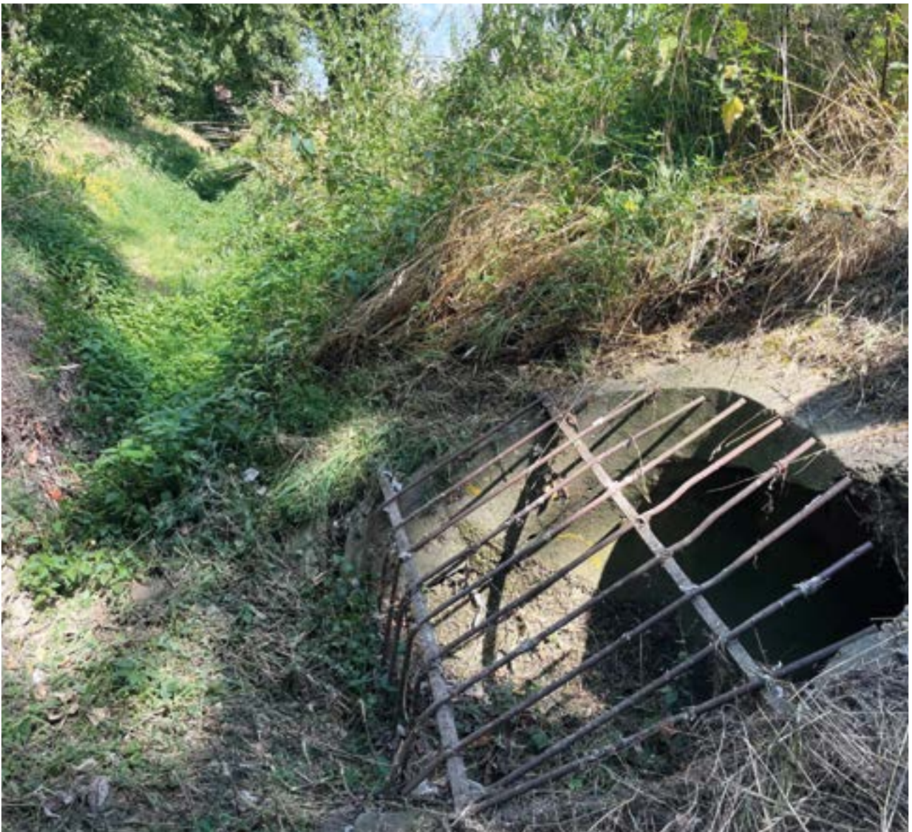
Notüberlauf in das Seelrather Fließ in Höhe der ehemaligen Kläranlage
