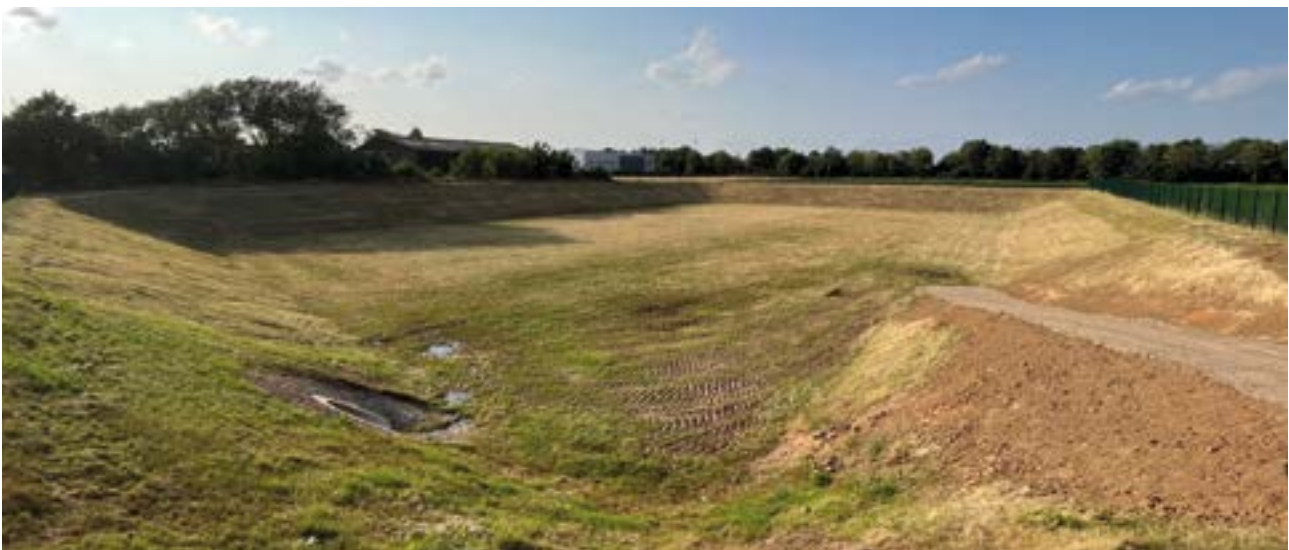
Versickerungsbecken Vicus-Quartier mit einem Volumen von 15.000 m 3 (Schutz > HQ 100)
